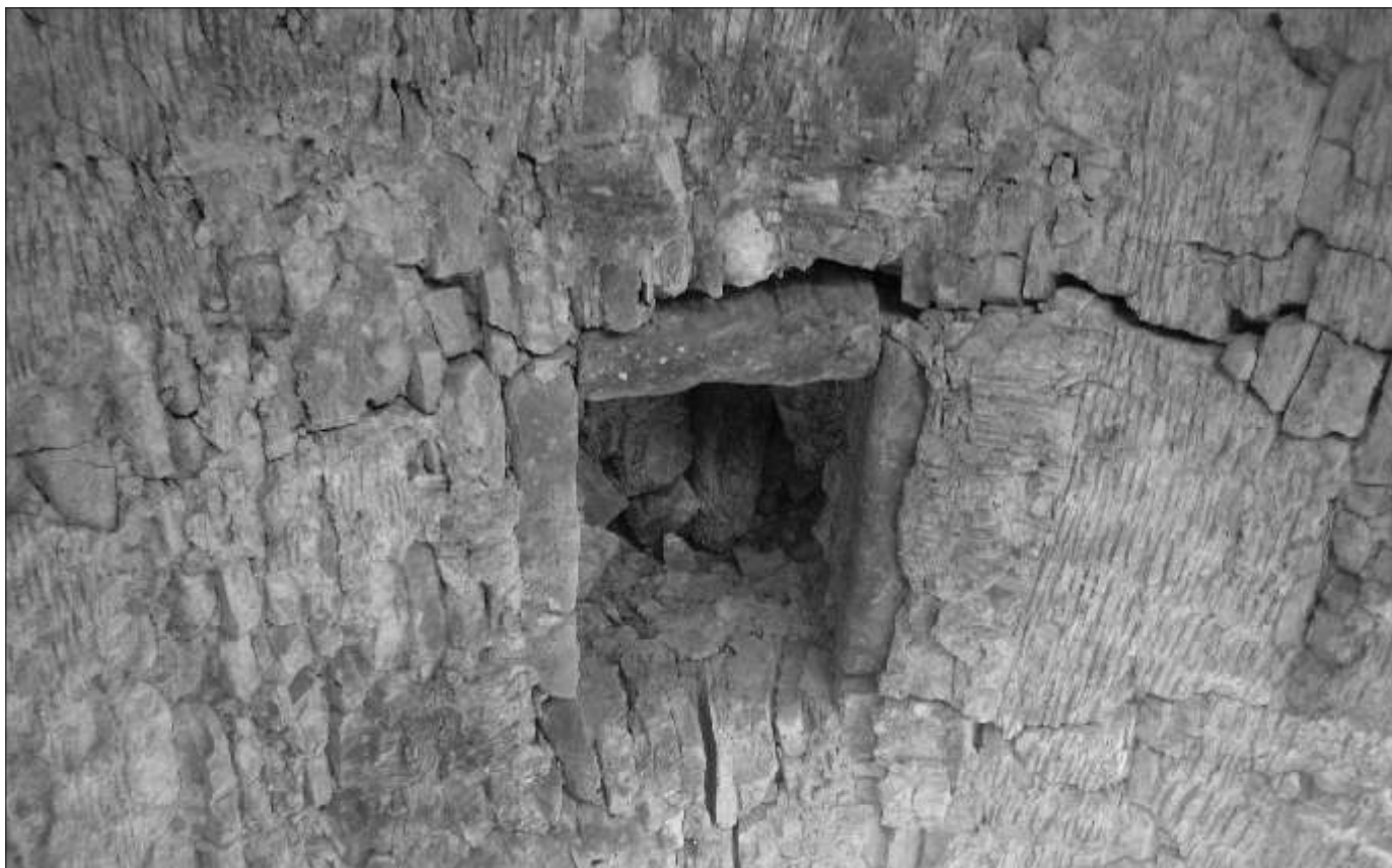
volta lesionata della cisterna interrata alla base della torre; la "finestrella" usata per il prelievo dell'acqua e, forse, per la "cacciata" della neve
